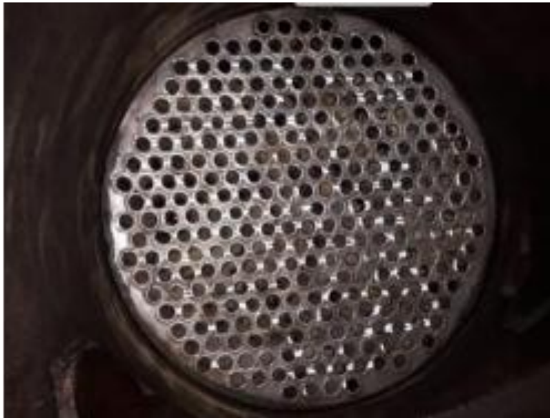
Gambar 6. Pipa heat exchanger kondisi normal tanpa kondensasi.
