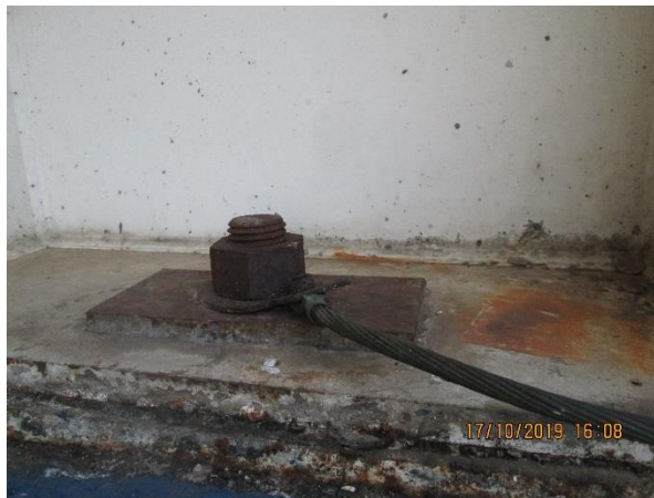
Gambar 7. Korosi pada bagian bolt and nut
