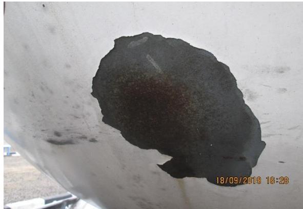
Gambar 6. Uniform corrosion pada bagian atas (2)
