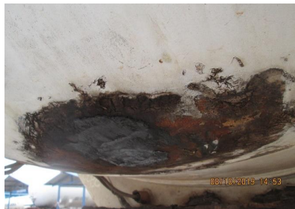
Gambar 5. Uniform corrosion pada head
